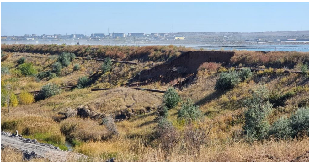
Рисунок 4 – Участок обрушения дамбы
